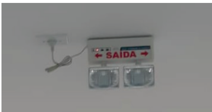
Figura 20: Luminária de emergência associada com sinalização Fonte: Luminária do Bloco 6, Setor 2 da Cidade Universitária
